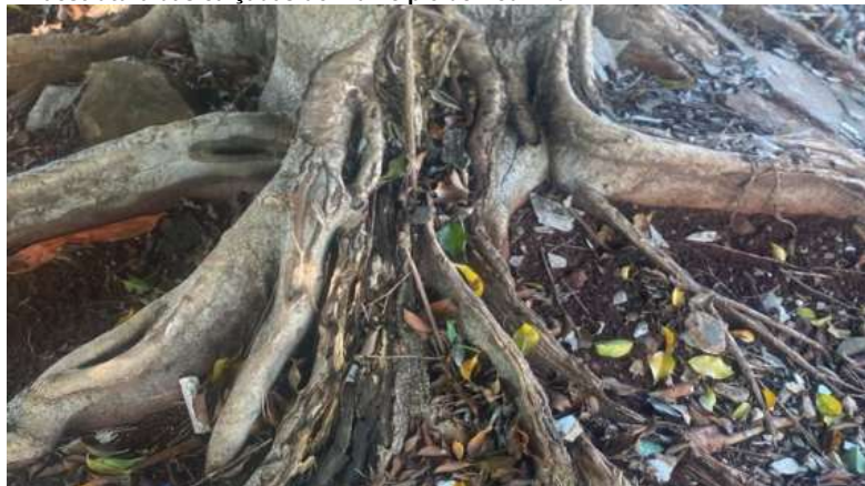
Figura 13 – Interferência do sistema radicular da arborização urbana na infraestrutura das calçadas do município de Céu Azul.
